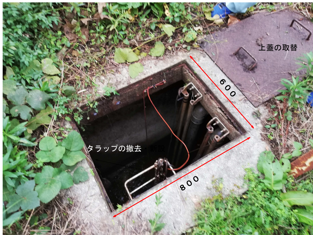
【中継ポンプ槽】
