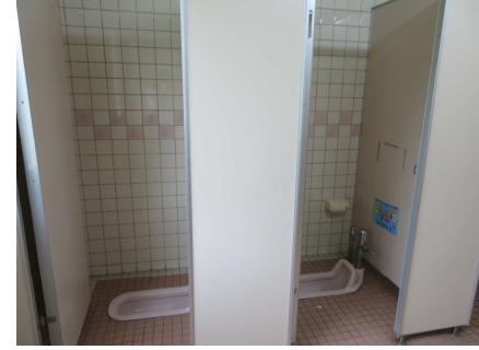
①改修希望箇所 奥から右側2か所
