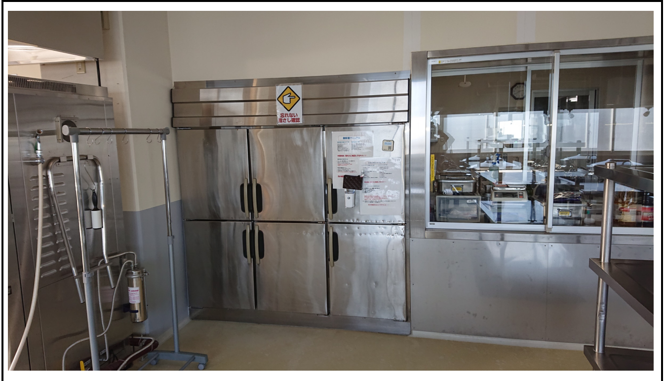
パススルー冷蔵庫 (調理室側)
