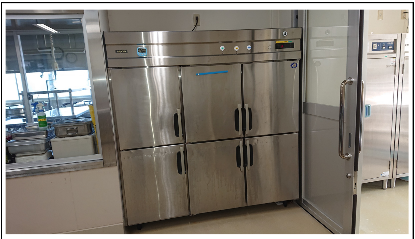
パススルー冷蔵庫 (下処理室側)
