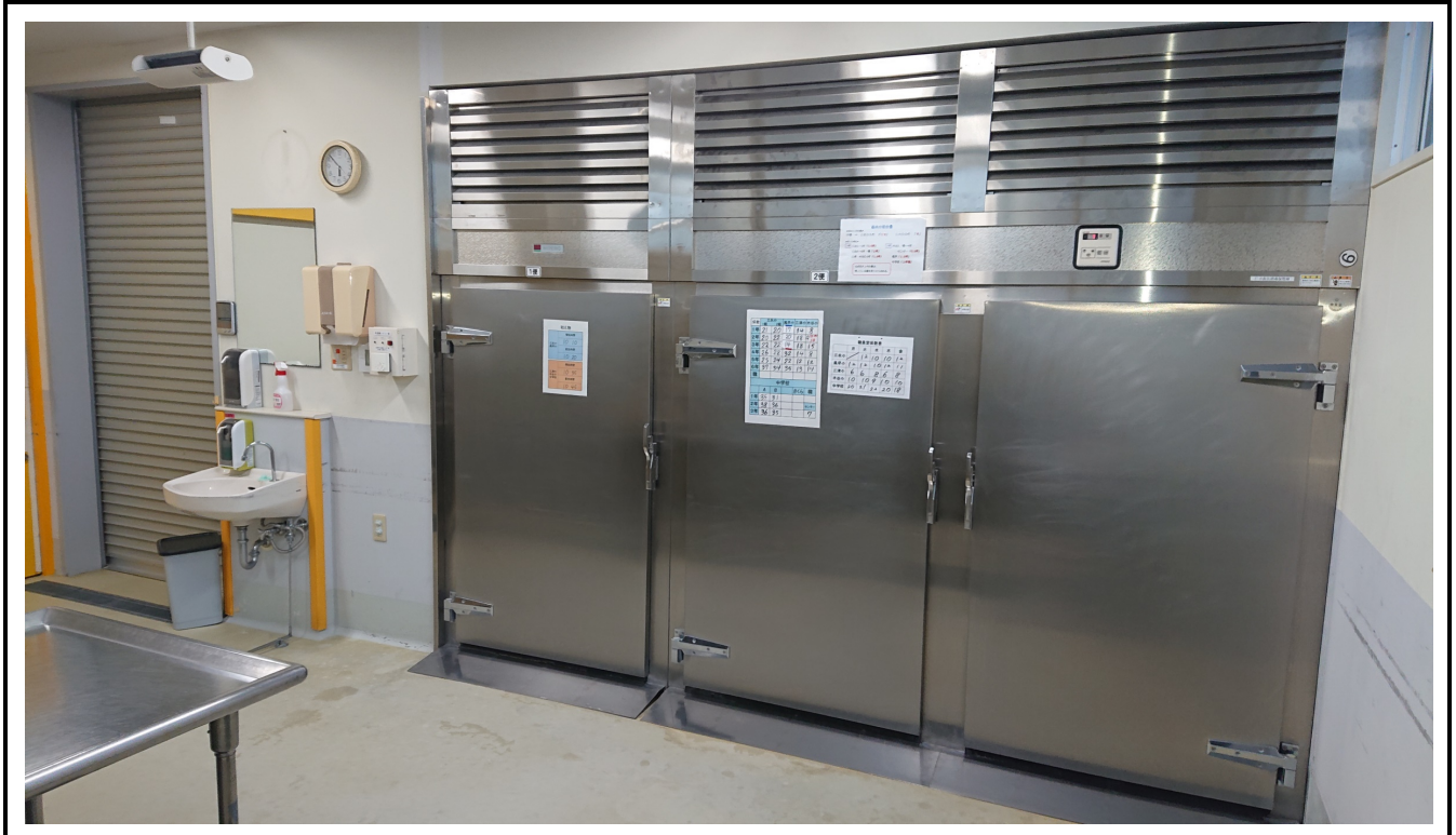
冷却機能付食缶消毒保管庫 (和え物室側)
