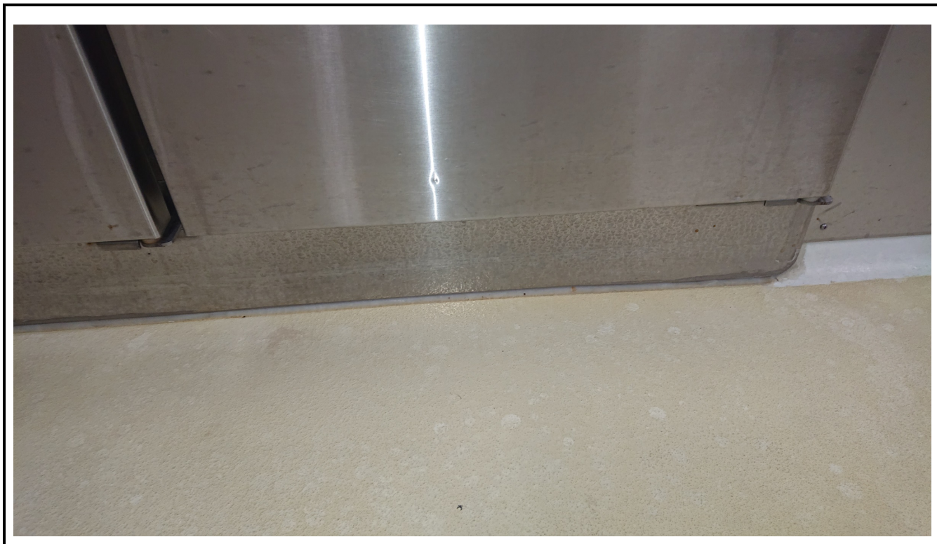
パススルー冷蔵庫 調理室側 床面(充填剤塗布箇所)
