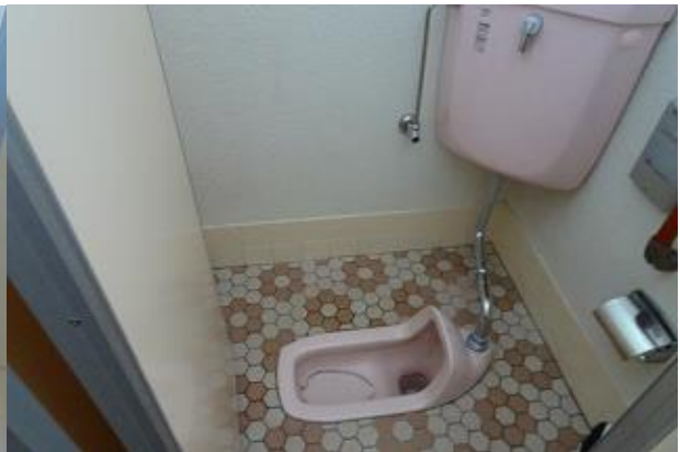
①改修便器
