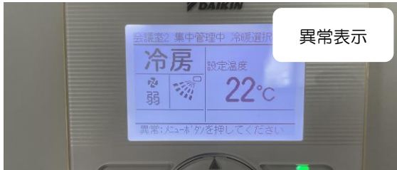
会議室2 リモコンエラー表示
