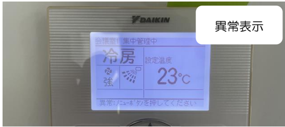
会議室1 リモコンエラー表示
