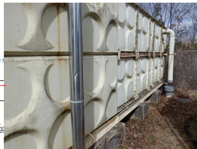
既設受水槽 (ポンプ室付)
