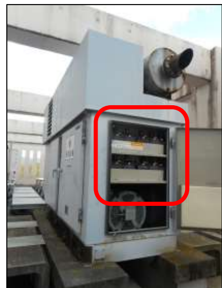
写真2：非常用自家発電装置側面
