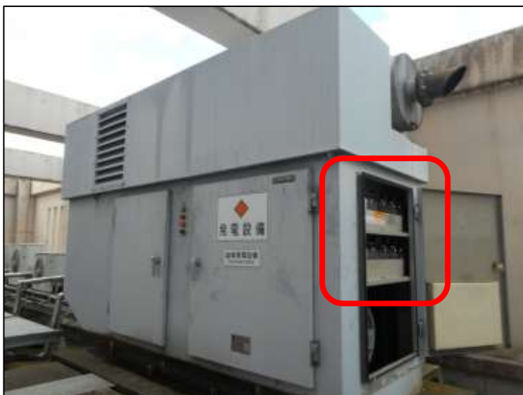
写真1：非常用自家発電装置正面
