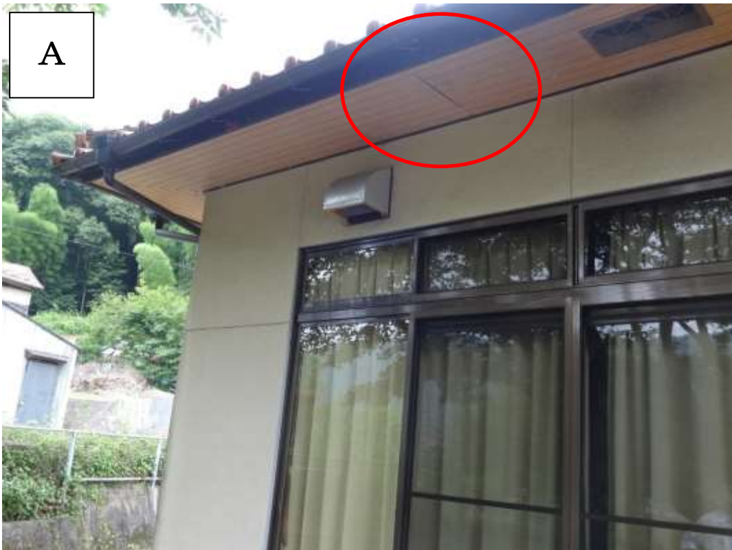
(3) 軒天釘留め (剥がれ部分 3箇所)
