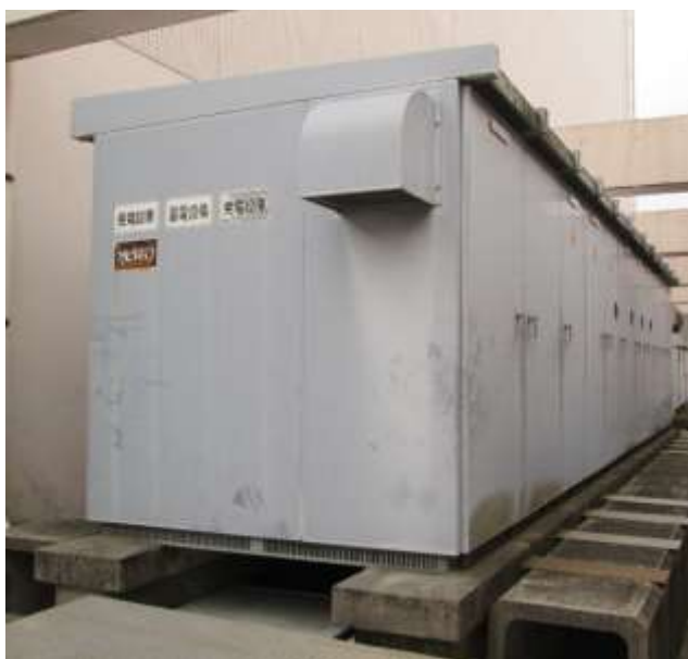
写真1 受電設備全景
