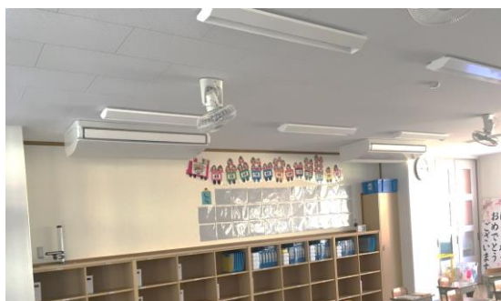
空調設備を整備した教室の様子
