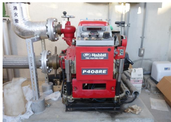
↑ 旧木原家住宅消防用ポンプ
