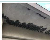
屋根の軒下の劣化
