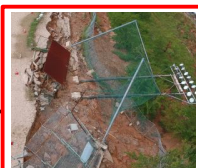
大雨時の雨漏りや災害に 繋がる可能性が高まる
