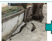
自然の力による構造物破損
