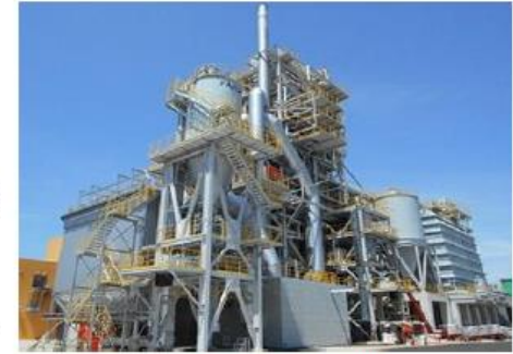
江津バイオマス発電所
