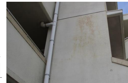
外壁劣化状況
