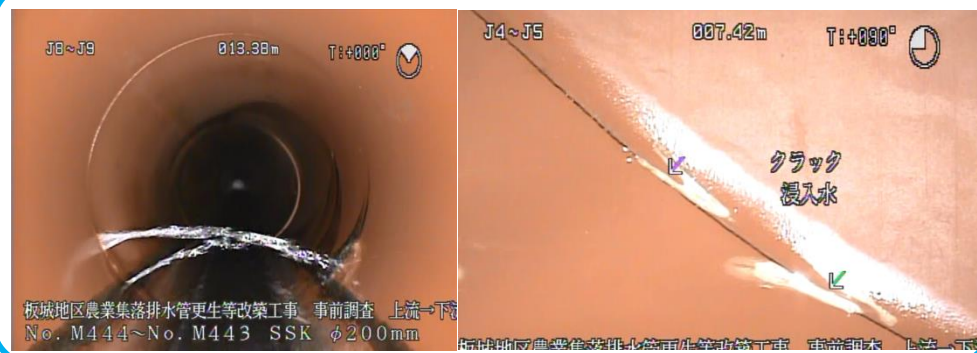
板城地区ハイセラミック管クラック状況
