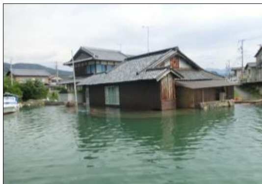
家屋浸水状況
